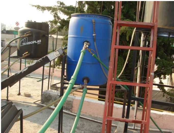
Foto 13 Termotanques no sellados
