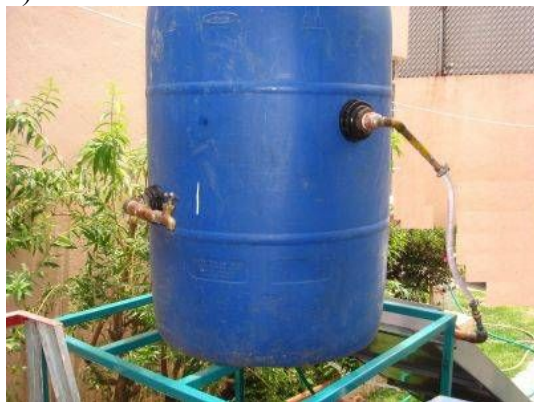
Termotanque antes del forrado
