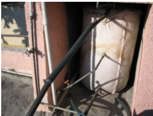
Foto 11 Termotanque sellado forrado de lana de fibra de vidrio cubierta por manta, colocado bajo interperie
