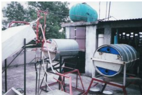
Foto 12 Termotanque sellado de plástico con cinchos de metal para evitar que se deforme.
