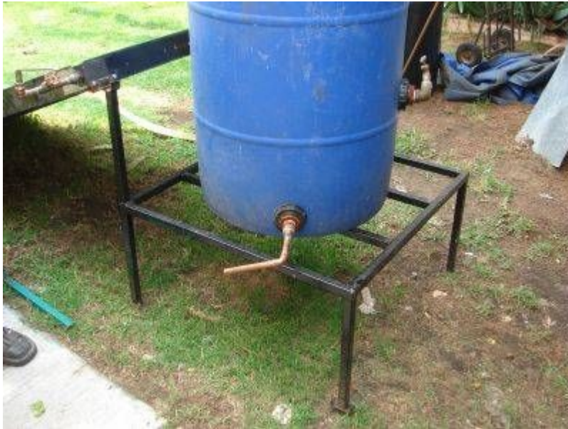
Foto 14 estructura para soportar el tinaco colocado verticalmente.
